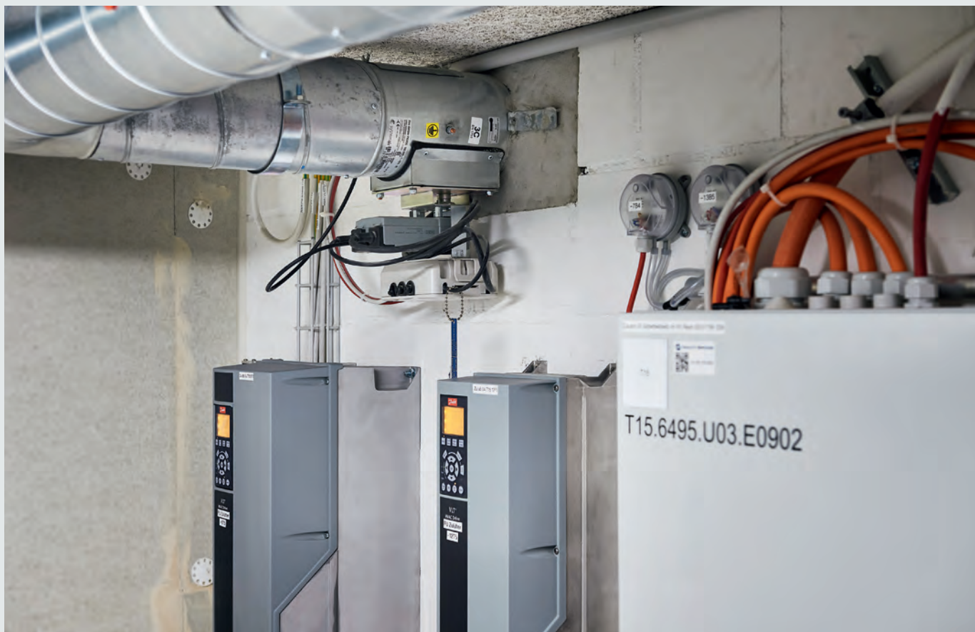
Abb. 3: Schon in der Planung wurde u.a. die Zugänglichkeit und damit die Wartungsfreundlichkeit der Brandschutzklappen berücksichtigt.
