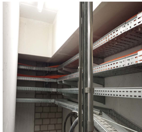
Traglast überschritten Leitungen über Trassenkante geführt
