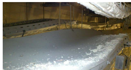
Verformung nach Brandversuch
