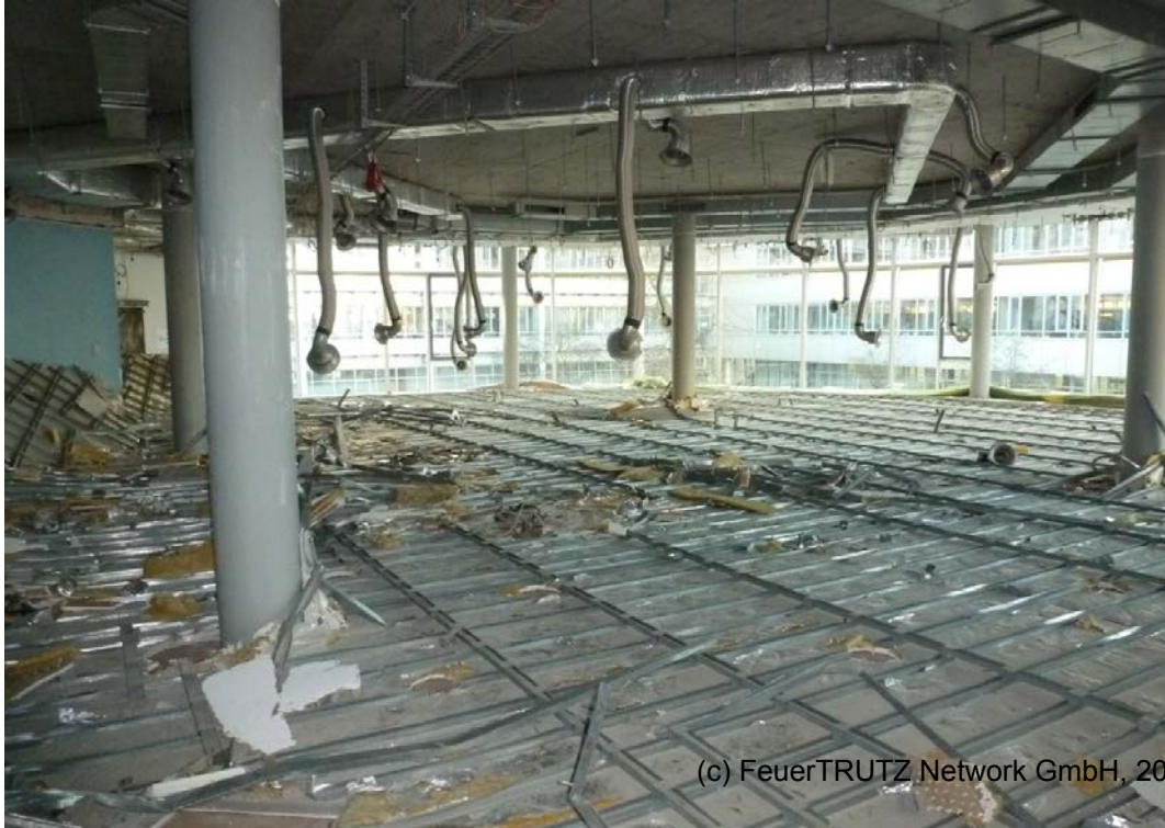
Deckenabsturz in Darmstadt
