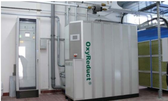
Steuerung und Membrananlage
