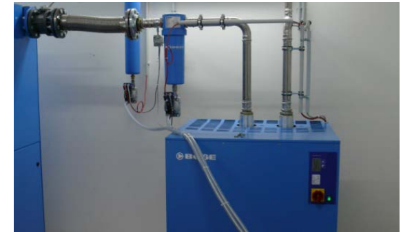
Trockner Kompressor anlage
