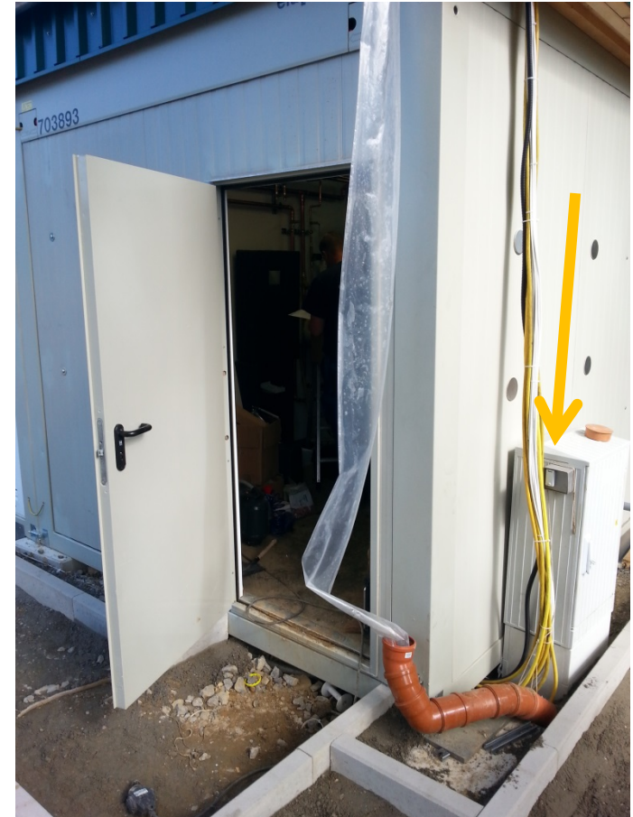
Bild 6: Hausanschlussraum mit Elektrohauptschalter
