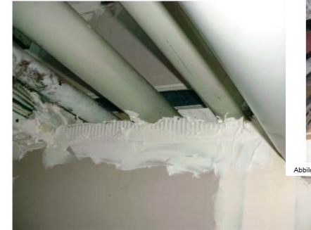
Abbildung 21: Kabel und Rohre durch F90 Trockenbauwand
