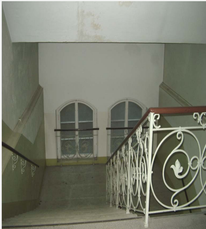
Keine Rauchableitung an oberster Stelle im Treppenraum
