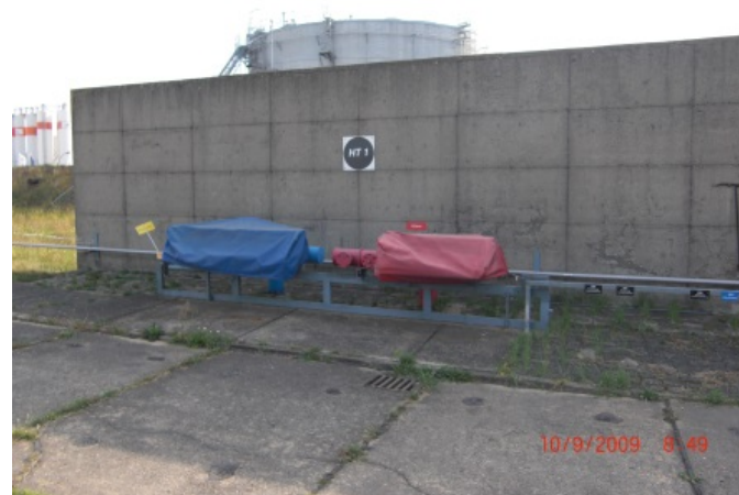
Einspeisestelle halbstationäre Löschanlage mit feuerbeständiger Schutzwand
