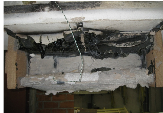
Stahlträger nach dem Brandversuch
