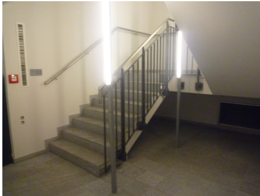
Druckbelüftungsöffnung und Druckregelklappe im Geschoss
