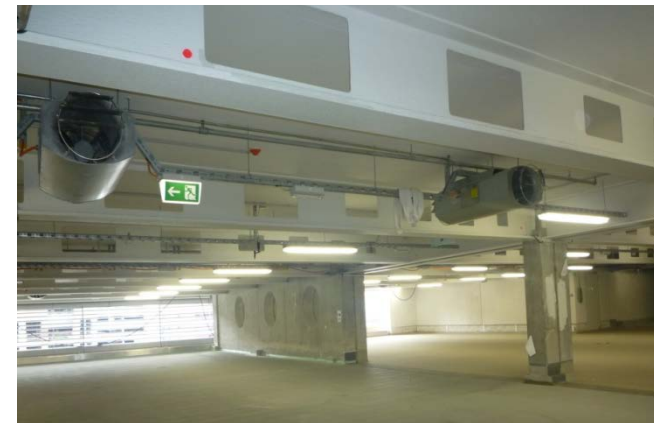
Garage mit Schubventilatoren
