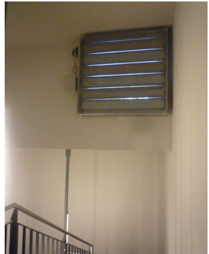
Druckregelklappe im Dachbereich
