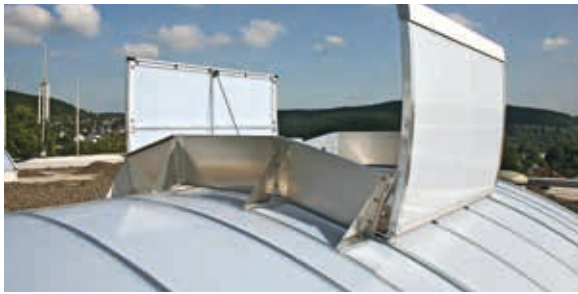
Dachlichtband mit geöffnetem NRW
