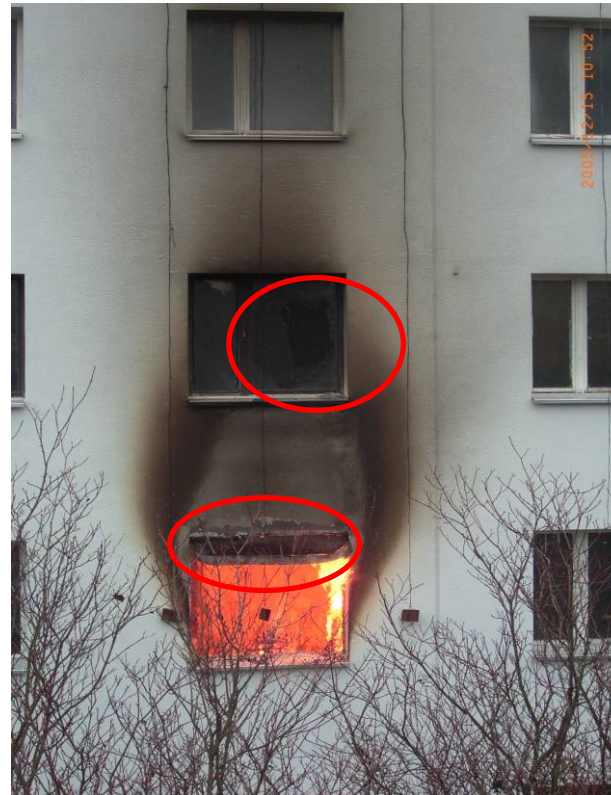
nach dem Versuch, Putz im Sturz offen Brandüberschlag durch Fenster
