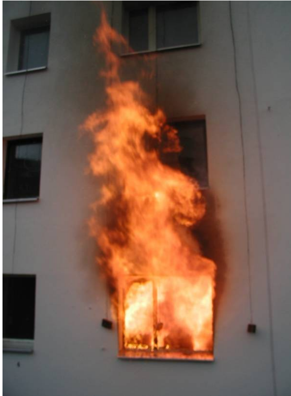
Vollbrand, Primärflamme bis über Fenstersturz der nächsten Etage hinaus (Fenster 2.)
